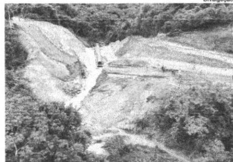
Chuva carregou o asfalto e abriu cratera na BR-222 entre Santa Inês e Santa Luíza
