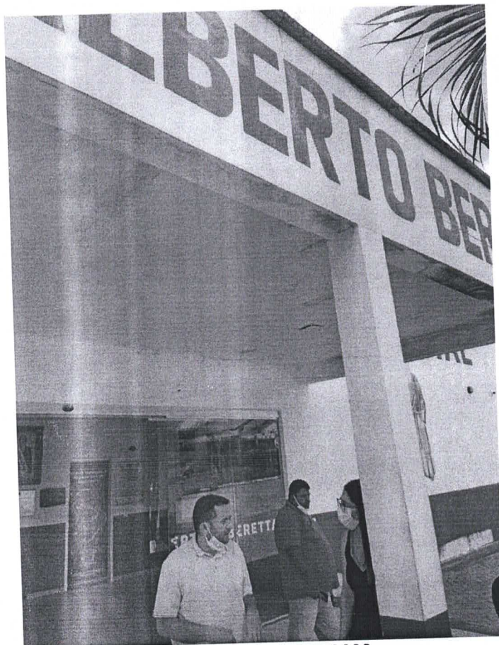
Figura 2 – Situação atual da cobertura da varanda.
