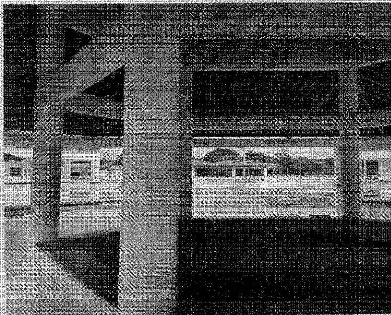
Figura 14 – Pilares necessitando de pintura
