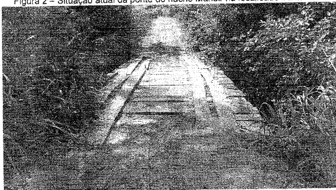
Figura 2 – Situação atual da ponte do riacho Mandir na localidade buritizinho.
