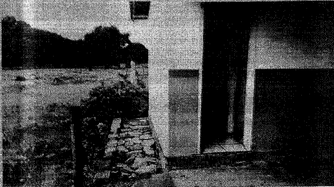
Figura 31 - Estado atual do piso da calçada
