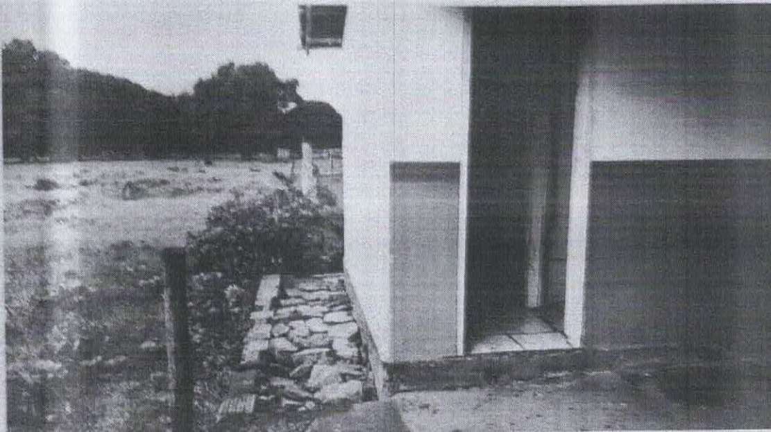
Figura 31 – Estado atual do piso da calçada.
