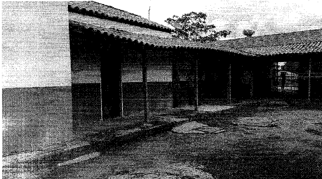
Figura 20 – Situação atual do telhado da varanda.
