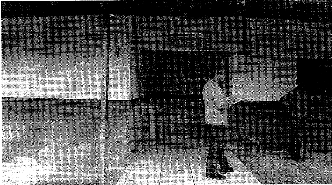
Figura 19 – Situação atual da pintura.
