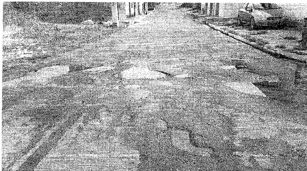
Figura 2 – Situação atual de pavimento asfáltico - Centro
