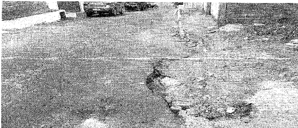
Figura 5 – Rua com pavimento, guia e sarjeta degradados no Centro de Sítio Novo-MA
