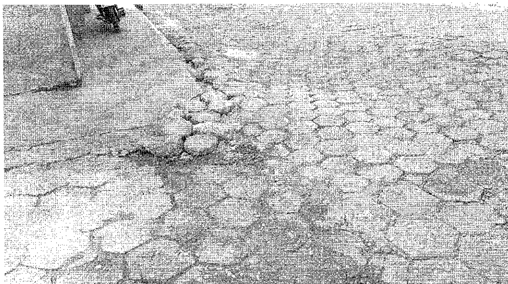
Figura 1 – Situação atual de pavimento em bloquete – Centro
