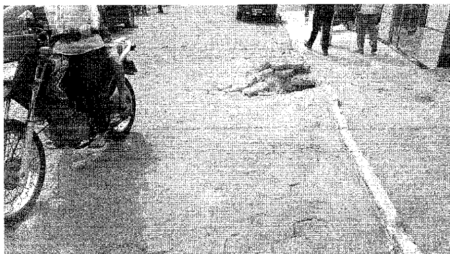
Figura 2 – Pavimento em bloquete em situação desgastada
